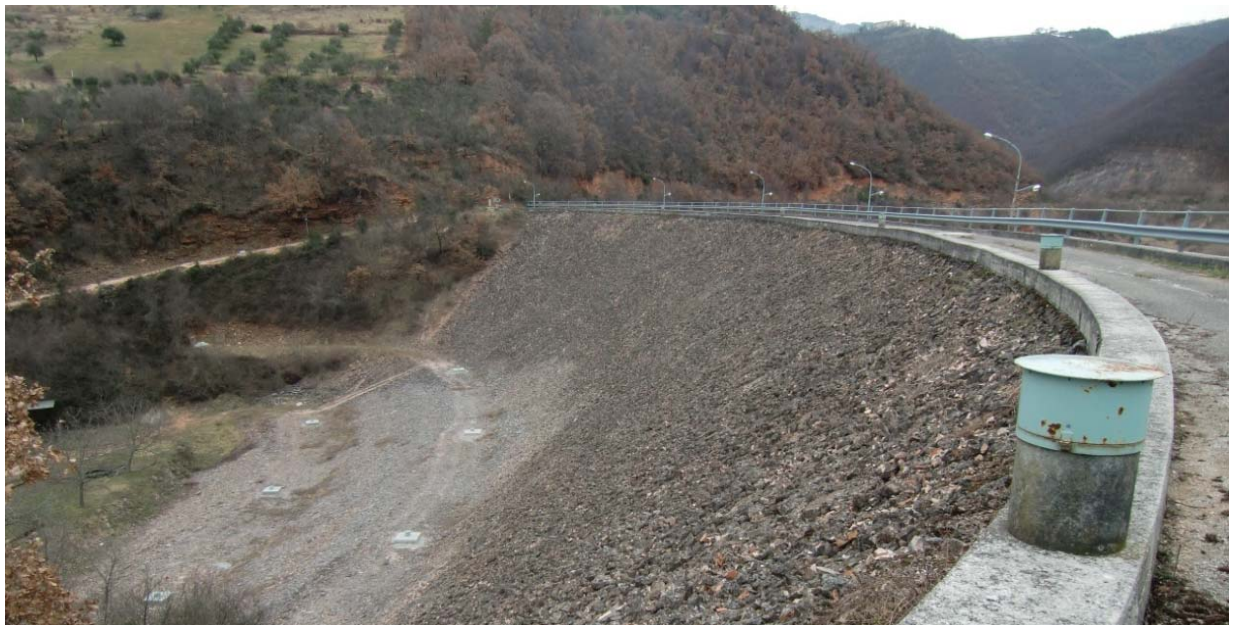
Figura 21 – Coronamento diga con capisaldi da rimuovere e riposizionare (quelli visibili sul paramento di valle verranno salvaguardati)
