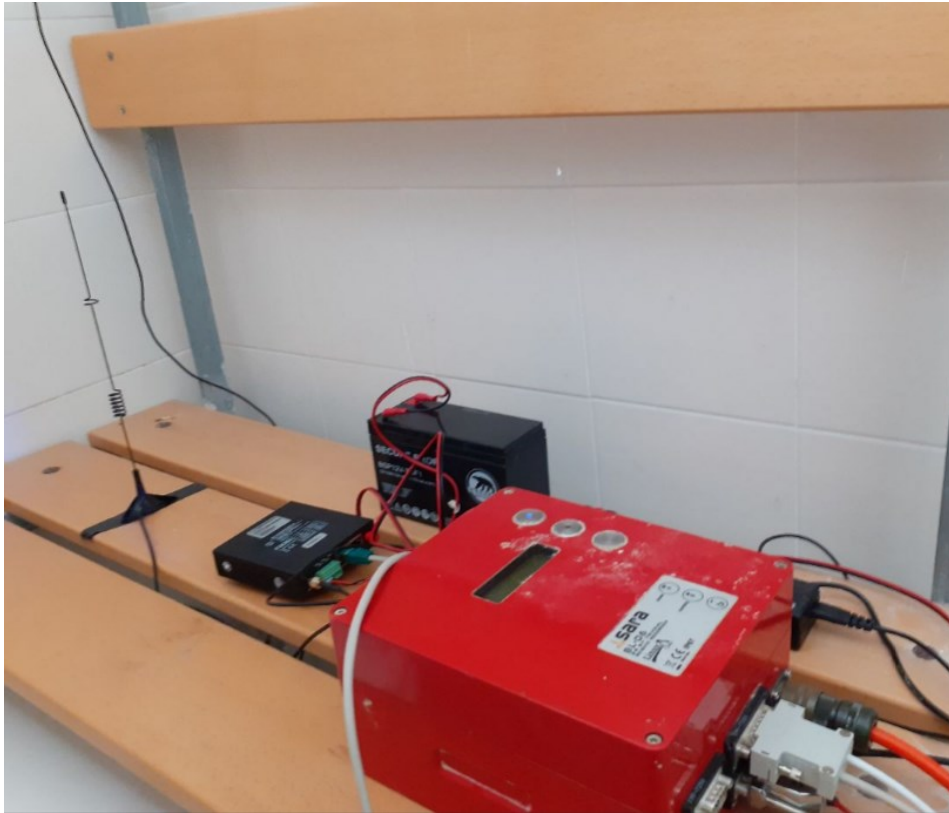
Stazione accelerometrica provvisoria ReSiR di Pierantonio, acquirente sismografo 24 bit (in primo piano), modem, antenna e batteria tampone
