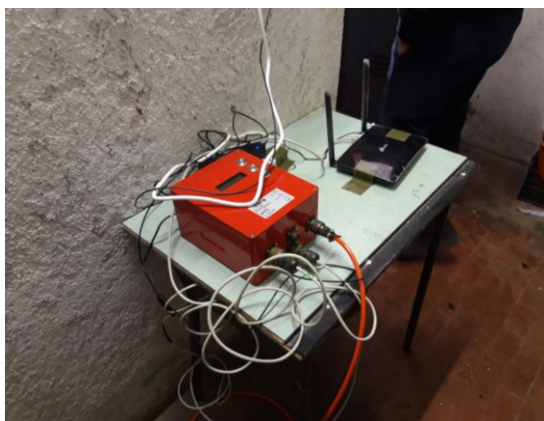
Stazione accelerometrica di Cascia
