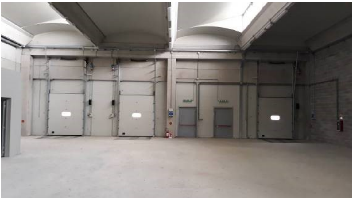
Magazzino Distribuzione – Particolare interno
