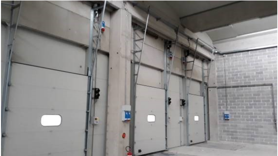
Magazzino Distribuzione – Particolare interno
