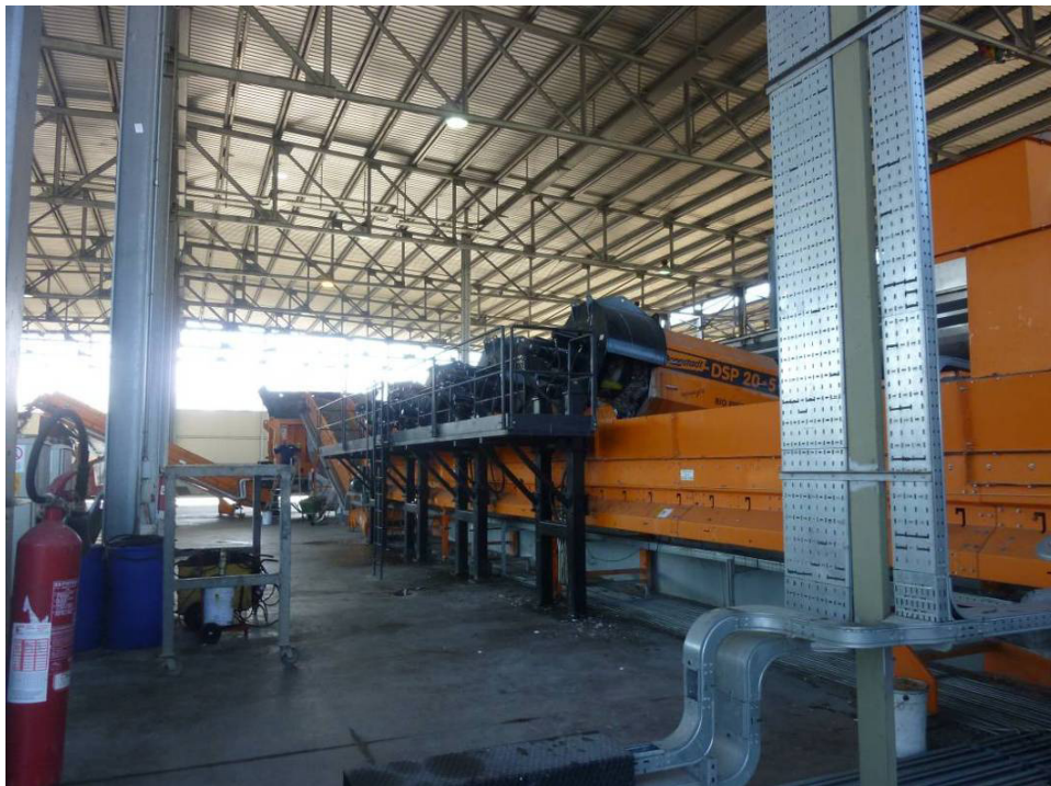
(Sezione di vagliatura e disidratazione del rifiuto in ingresso all’impianto)
