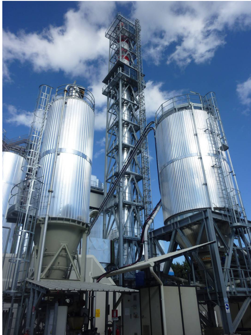
(Silos stoccaggio reagenti_bicarbonato e carbone attivo)
